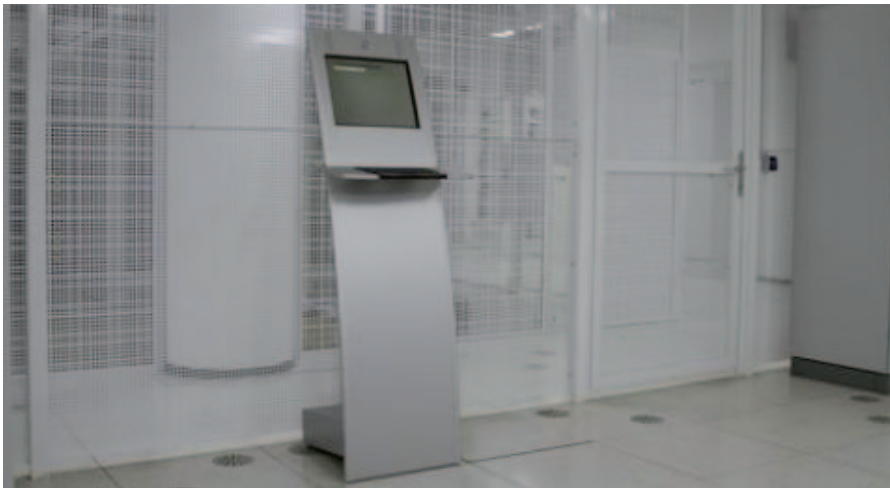
Zutrittsschutz für Servergänge
