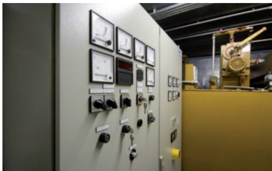
Diesel-Aggregate für längeren Stromausfall
